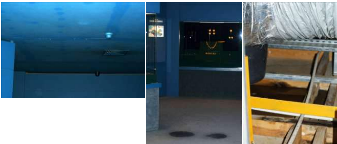
Infiltração de água proveniente do sistema de ar condicionado.
