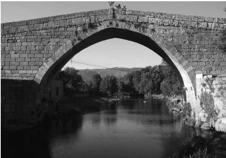
Fig. 4 – O arco maior da ponte, sendo bem visível uma pequena deformação na secção esquerda.
