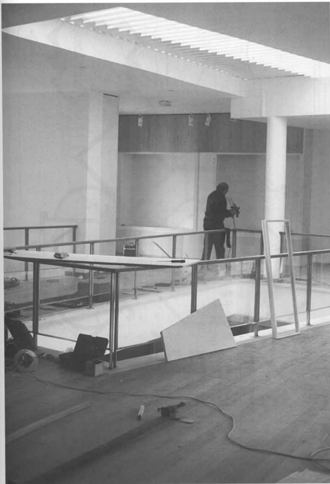
Fig. 8 – Fase da obra de arranjos interiores do 1.º andar do espaço-museu do Rabaçal. Trabalhos de marcenaria de José Antero. Fotografia de Miguel Pessoa, 1999.
